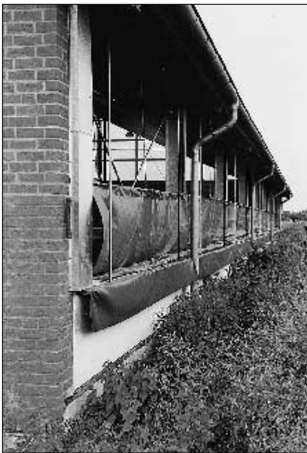
Bild 2: Wickellüftungen ermöglichen einen hohen Luftaustausch (Fotos: W. Achilles)
