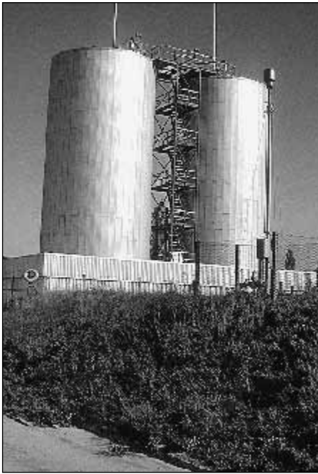
Bild 1: Moderne zweistufige Biogasanlage
