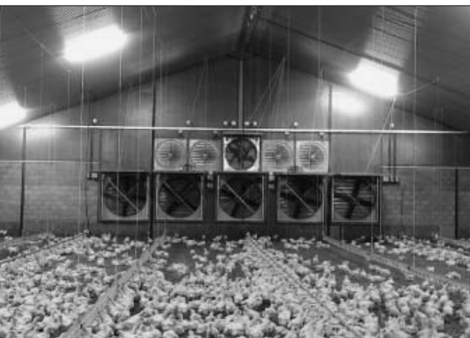
Bild 1: Bei der Tunnellüftung wird die Abluft an einer Stirnseite abgesaugt Foto Fancom
