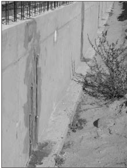
Bild 1: Undichtigkeiten am Güllekanal - Neubau
