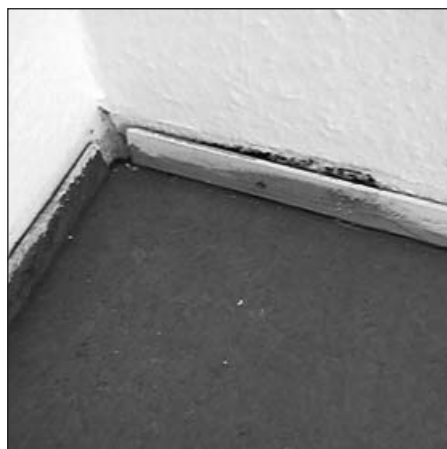
Bild 2: Schimmelpilz hinter Fußleisten im Wohnbereich
