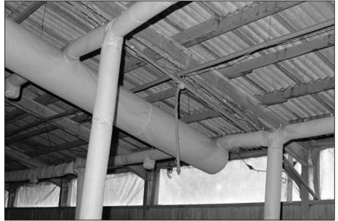
Bild 2: Ausschnitt des Systems zur Tracergasverteilung mit Hauptverteiler, Nebenverteiler und zwei senkrechten Auslässen
