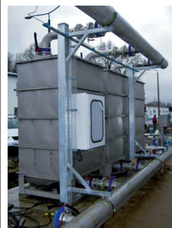
Entschwefelungssystem einer 2 MW el Biogasanlage (Foto: AdFiS systems GmbH), Fig. 3: Desulfurization system of a biogas plant (2 MW el )
